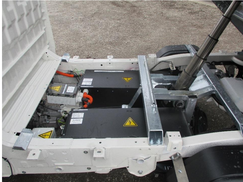
1. Batteriekasten, 2. Hauptfreischaltsicherung, 3. Servicesicherung
