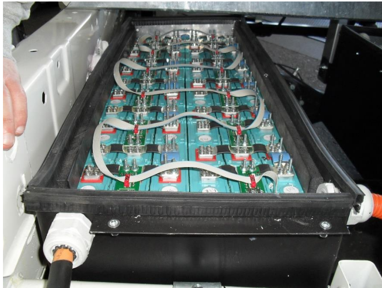
Batteriekasten mit LiFePo4 Akkus
