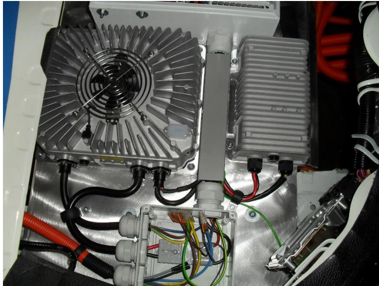
1.Ladegerät, 2.DC-DC Wandler und 3.Ladungsverteilerkasten offen.
